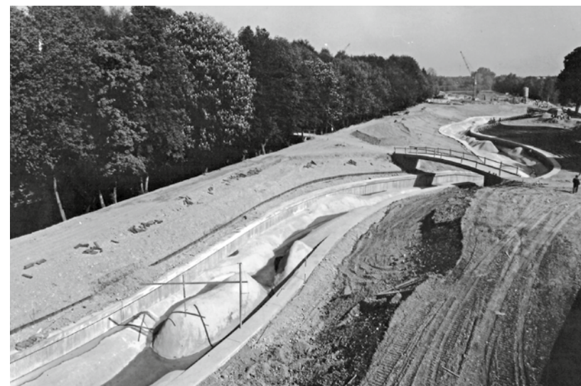
Strecke und Gaststättengebäude im Bau, Ansicht von Süden, wohl 1971 Quelle: Architekturmuseum Schwaben
